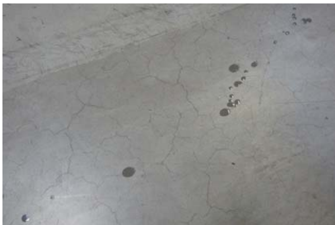
Fot. 5. Sieć spękań powierzchni posadzki
