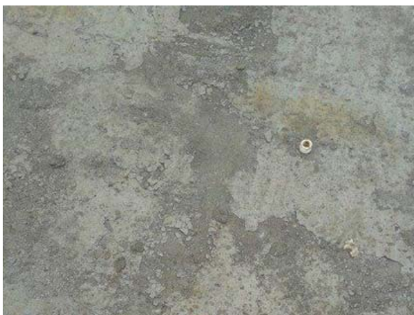
Fot. 3. Zwiększona ścieralność posadzki betonowej wywołana bleedingiem
