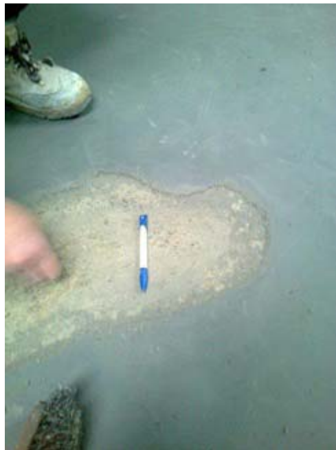
Fot. 4. Delaminacja górnej warstwy posadzki spowodowana wydzieleniem wody
