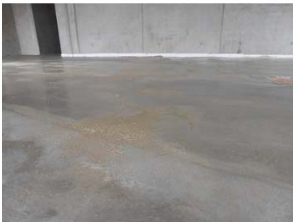
Fot. 2. Wydzielenie wody wraz z domieszką chemiczną na powierzchnię zabudowanej mieszanki
