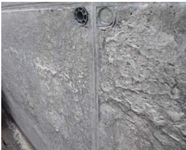
Fot. 1. Przykład bleedingu kanałowego
