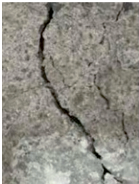
Fot. 1. Zarysowanie betonu przed rozpoczęciem procesu samoregeneracji [12]
