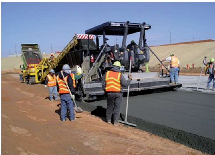
Fot 10. Wrzesień 2010 – pierwsza realizacja RCC, autostrada 78 w Aiken (Karolina pld.); usunięto asfalt i położono 254 mm RCC; długość 1,6km, cztery pasy ruchu, zagęszczenie – walec 12t + walec ogumiony; nawierzchnia wykończona metodą NGCS
