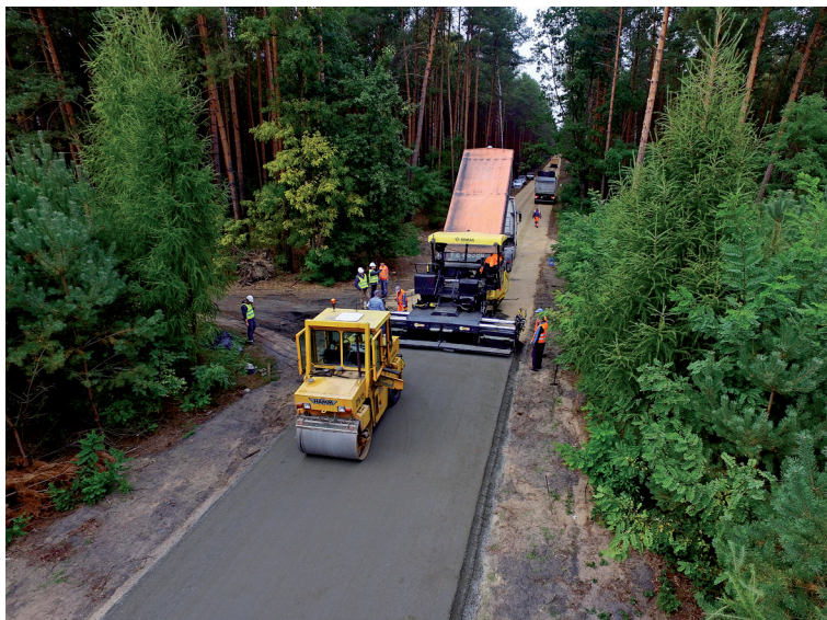
Fot. 5. Wzorowo prowadzony proces wbudowywania mieszanki. Samochód ze skrzynią przykrytą plandeką, walec zagęszczający nawierzchnie zaraz po przejściu rozścielacza, kolejne ciężarówki już podjeżdżają pod rozkładarkę; praca maszyny płynna bez przestołów (Archiwum LafargeHolcim)
