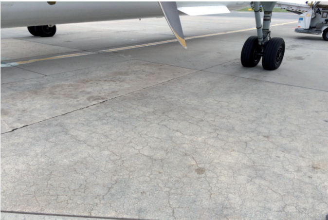
Fot. 1. Zarysowana nawierzchnia płyty postojowej – Lotnisko Chopina w Warszawie 2016
