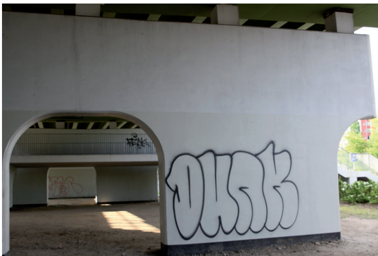
Fot. 4. Zabrudzenie powierzchni przez malunki graffiti
