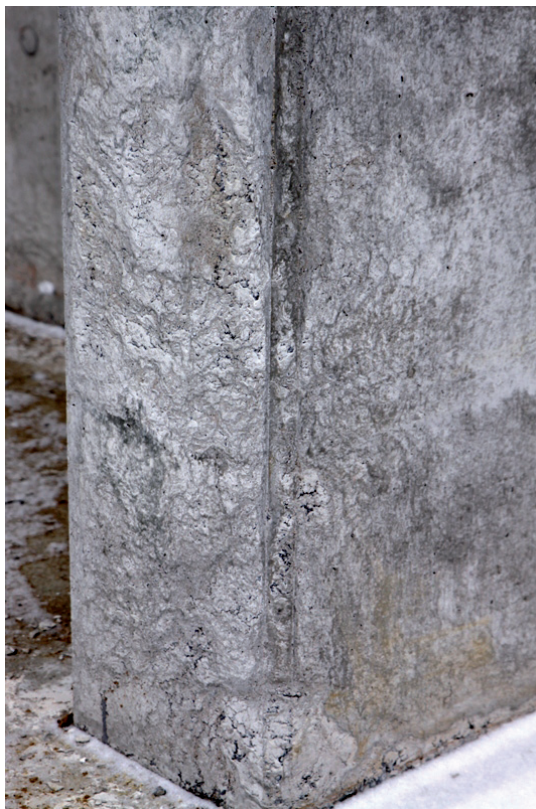
Fot. 5. Efekt rozsegregowania mieszanki w narożniku przyczółku
