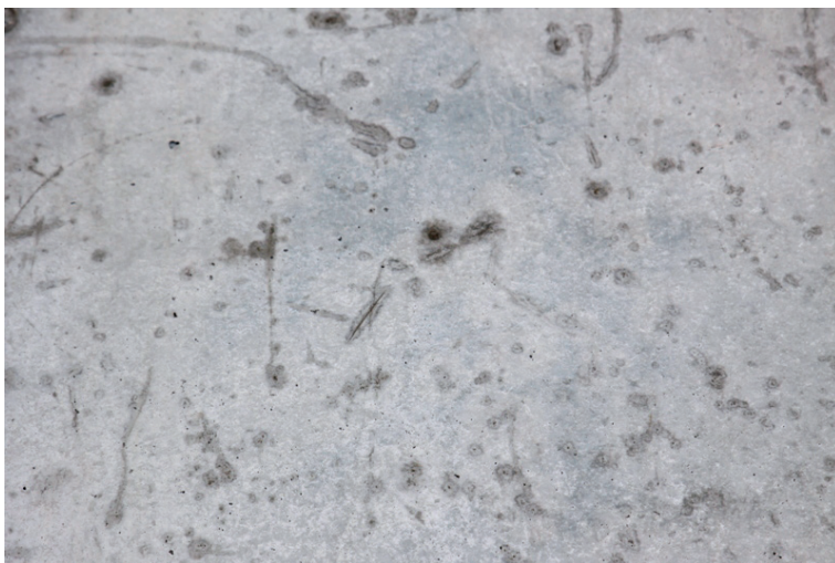
Fot. 3. Efekt zastosowania deskowania o zniszczonej powierzchni
