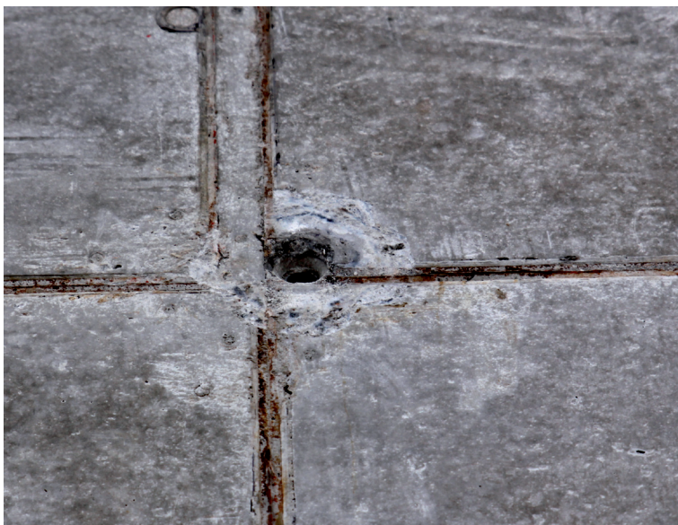
Fot. 4. Nieprawidłowo wykonana naprawa wycieku mleczka
