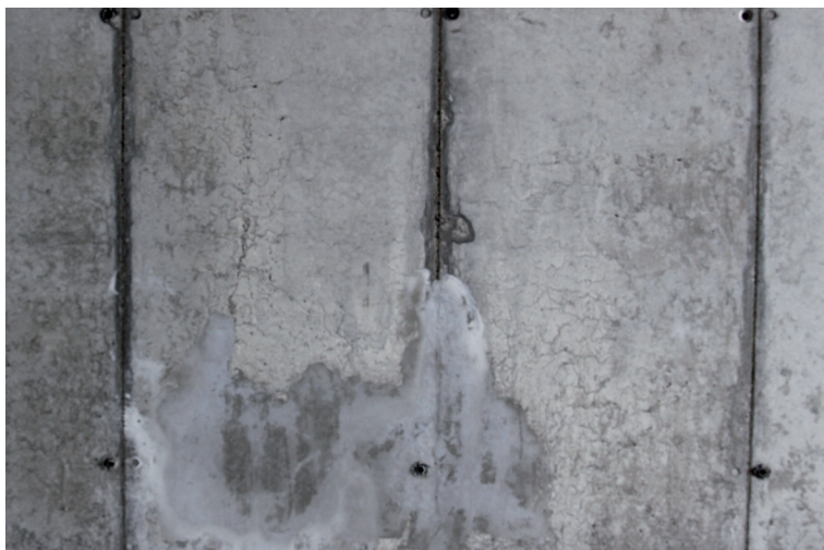
Fot. 8. Nieprawidłowa naprawa wady powstałej w wyniku rozsegregowania mieszanki
