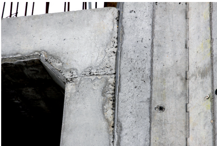
Fot. 6. „Gniazda żwirowe” w części zewnętrznej przejazdu
