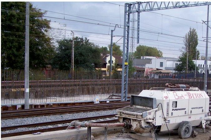
Fot. 2. Pompa stacjonarna z widocznym fragmentem rurociągu
