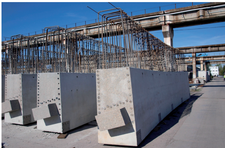
Rys. 12. Prefabrykowane belki o zakrzywionym kształcie z wystający zbrojeniem startowym powłoki (a) oraz schemat montażu belki na słupach (b) [1]
