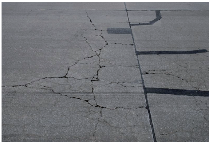
Fot. 2. Płyta betonowa zakwalifikowana do wymiany
