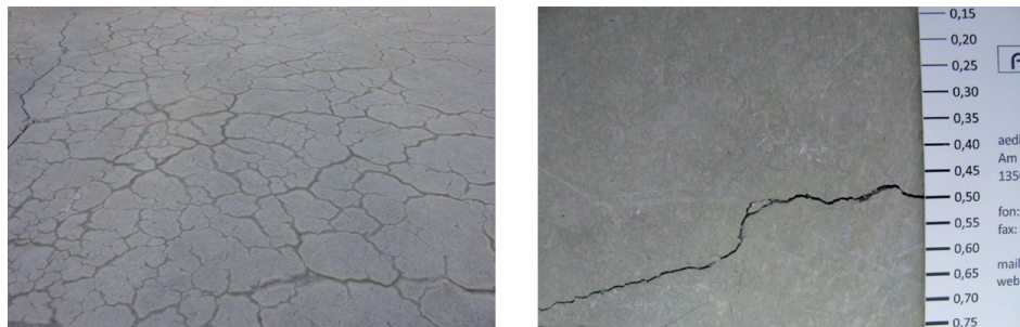
Rys. 2. Pęknięcia powierzchniowe betonu spowodowane powierzchniowym skurczem porów kapilarnych w wyniku intensywnego wysychania [6], [7]
