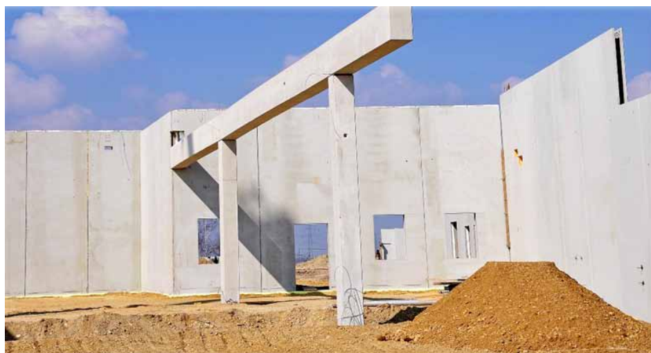
Fot. 1. Budynek w trakcie realizacji z wykorzystaniem prefabrykowanych ścian, słupów i belek
