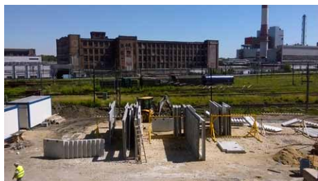
Fot. 8. Plac magazynowy, ściany wyposażone w peszle i puszki elektryczne oraz bruzdy instalacyjne
