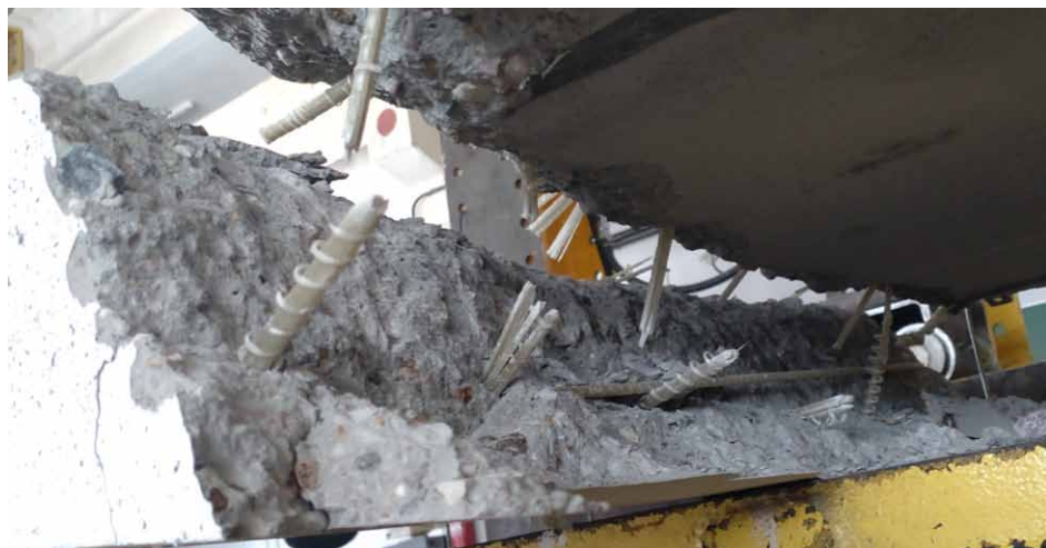
Rys. 8 Płyta B2-G-E po zniszczeniu na ścinanie
